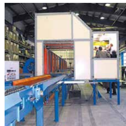
Bedienungskabinen und Anlagenkapselung
