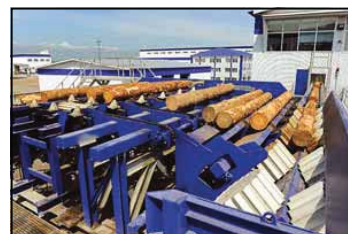
Линия подачи бревен в лесопильный цех
