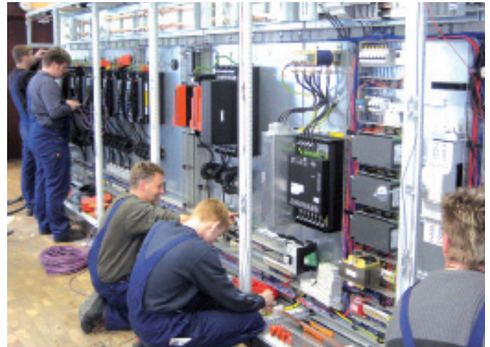
Leistungsstarker eigener Schaltanlagebau sowie eigene Elektrokonstruktion bei Holtec
